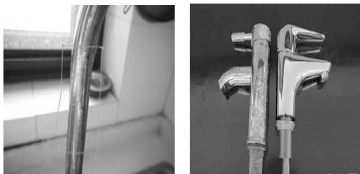
图 2-25 生活用花洒表面镀层脱落对比图
