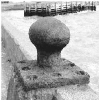
图 1-8 海岸固定船只的金属固定座腐蚀图片
