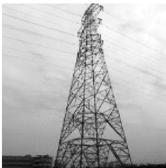
图 8-25 热喷涂后的输变电 铁塔大型钢铁构件
