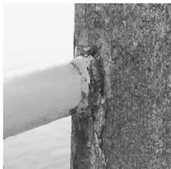
图 2-29 海洋环境下铁护栏遭严重腐蚀的形貌
